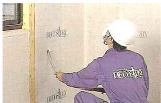
壁体内にホースを挿入し、専用施工機からセルロースファイバーを隙間無く吹き込む
